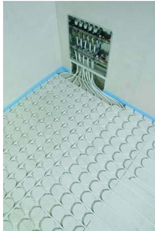
Rohrführung im Verteilerbereich
